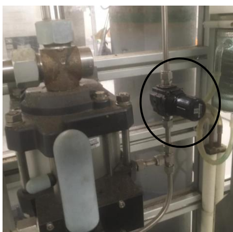
Válvula de entrada de ar comprimido.
