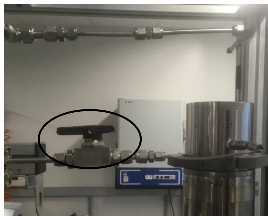
Válvula de bloqueio que restringe o fluxo de CO 2 .
