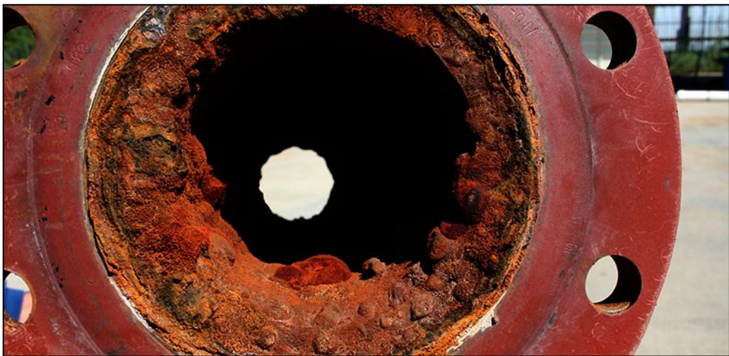
Figura 5.1. Corrosão em tubulação de aço ao carbono em presença de \text{CO}_2 . Fonte: Schulich, 2010.
