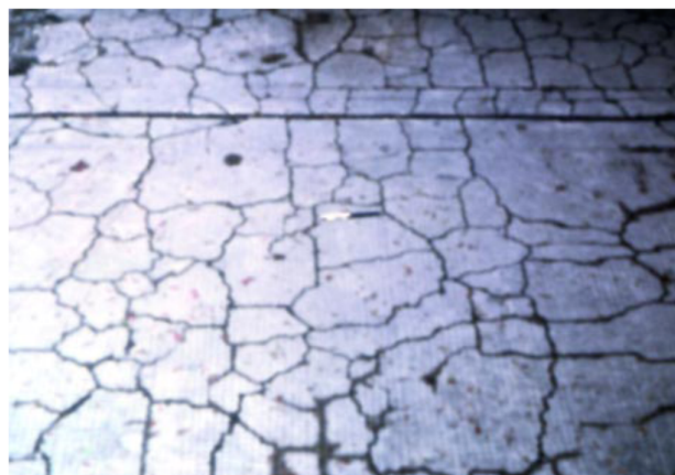
Figura 3.8 - Mapa padrão de fissuras causadas pela reação álcali-agregado. Crédito da imagem: Portland Cement Association (PCA), 2002.
