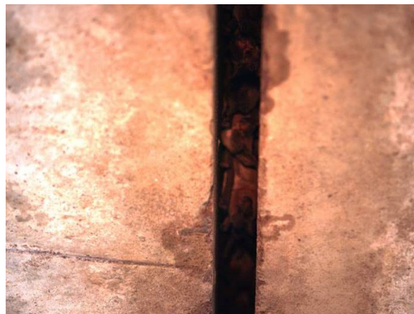
Figura 3.1- Morcegos alojados em junta de dilatação de um viaduto. Credito da imagem:autor.
