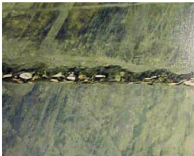
Figura 3.4 - Danos causados pelo impacto do tráfego de veículos nas bordas das juntas de dilatação das rodovias. Credito da imagem: Portland Cement Association (PCA), 2002.
