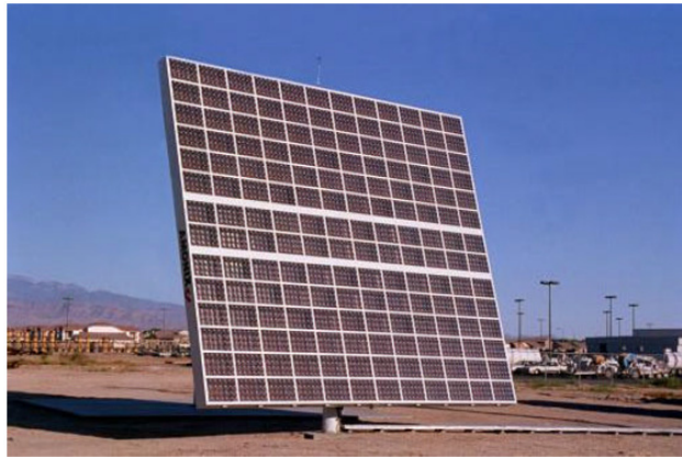
Figura 2.2. Arranjo fotovoltaico constituído por módulos fotovoltaicos concentradores Amonix [12].
