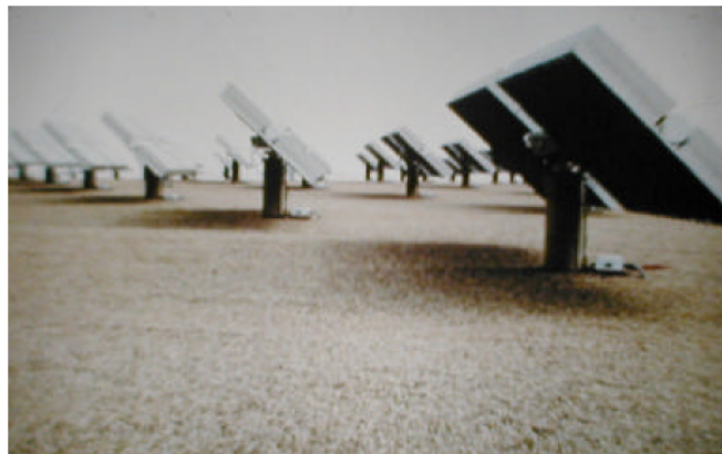
Figura 2.1. Sistema fotovoltaico Soleras, na Arábia Saudita [5].
