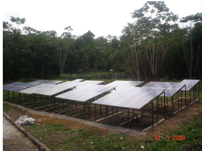
Figura 2.58. Arranjo de módulos do sistema fotovoltaico isolado na estação científica Ferreira Penna, PA [45].
