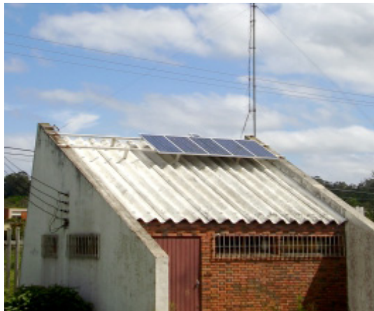
Figura 2.62. Módulos fotovoltaicos localizados no telhado de um dos prédios do LABSOL - UFRGS, com potência de 500 Wp [47].
