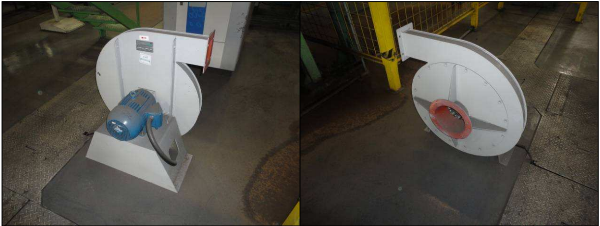
Figura 4.8. Ventilador OTAM® selecionado para o projeto do sistema instalado em uma base de aço no chão da fábrica. (a) visão do motor e (b) visão da admissão.
