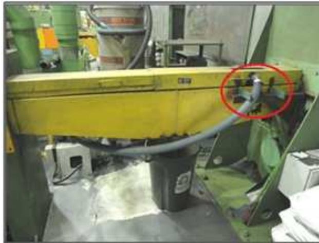
Figura 5.1. Local da laminadora onde foi instalado o sistema de secagem de fio máquina. Em destaque o duto flexível por onde passa o ar.
