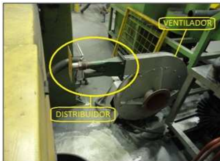
Figura 5.5. Distribuidor conectado ao ventilador para a distribuição do ar nos bicos do sistema A.
