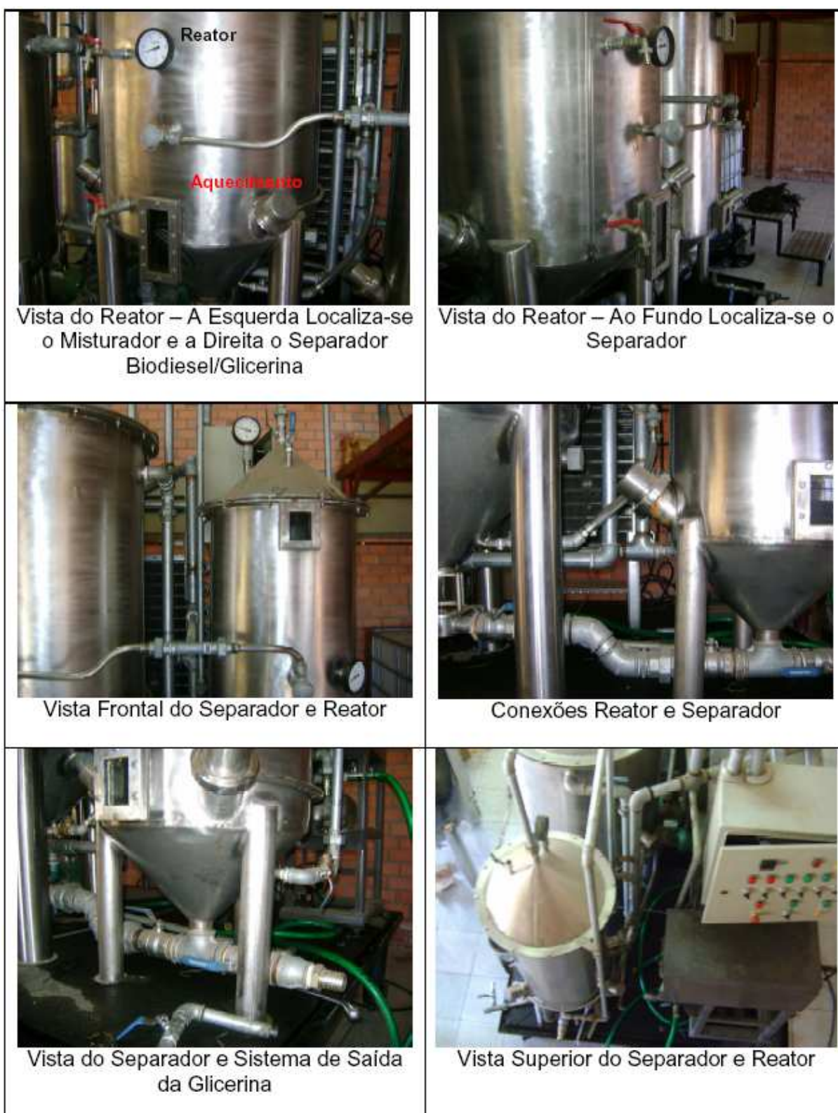
Figura 4.6. Detalhes dos reatores da mini-usina piloto de biodiesel.
