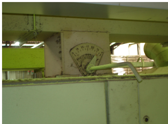
Figura 3.27 - Damper aberto em 75%.
