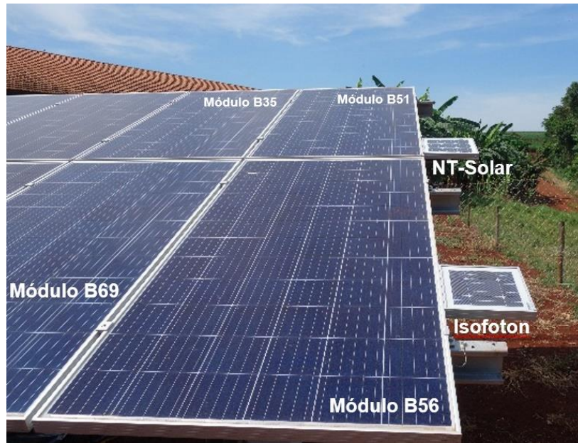
Figura 4.34. Células solares (Isfoton e NT-Solar) de referência colocadas na estrutura de fixação ao lado dos módulos fotovoltaicos de teste.
