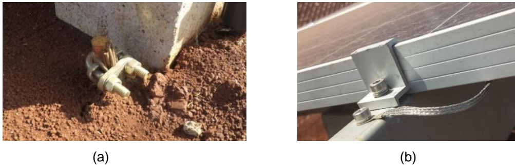
Figura 4.29. (a) Conector de aperto para conectar cabo a haste de aterramento e (b) Ligação da estrutura de alumínio do módulo FV com estrutura galvanizada.
