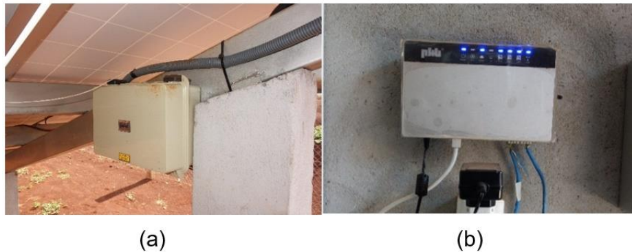
Figura 4.26. Caixa do sistema de monitoramento onde estão os circuitos eletrônicos de medição, sob os módulos FVs e (b) PHB logger, na casa de passagem.
