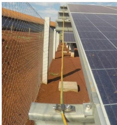
Figura 4.30. Fiação utilizada para conexão entre estruturas e painéis.
