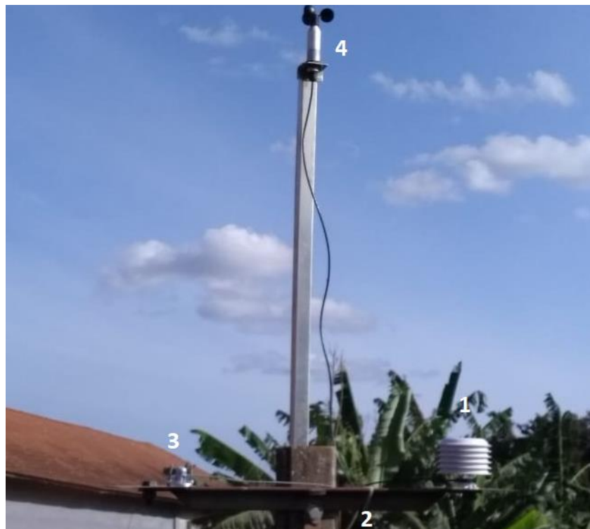
Figura 3.6. Sensores do sistema de monitoramento: 1 - sensor de temperatura ambiente, 2 - sensor de temperatura dos módulos fotovoltaicos (colado na face posterior de um módulo fotovoltaico), 3 - piranômetro e 4 - anemômetro
