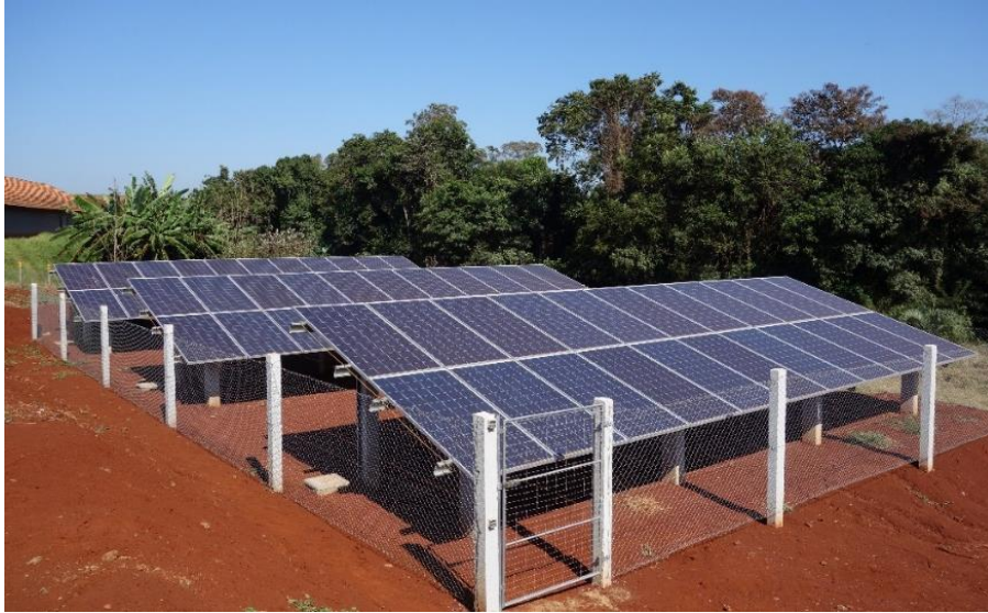
Figura 4.13. Vista do arranjo FV concluído.
