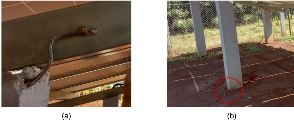
Figura 4.28. (a) Cabo de cobre nu de 50 mm 2 de secção reta, interligado à estrutura metálica e (b) ponto de colocação das hastes de aterramento do sistema, ao lado do pilar de concreto.
