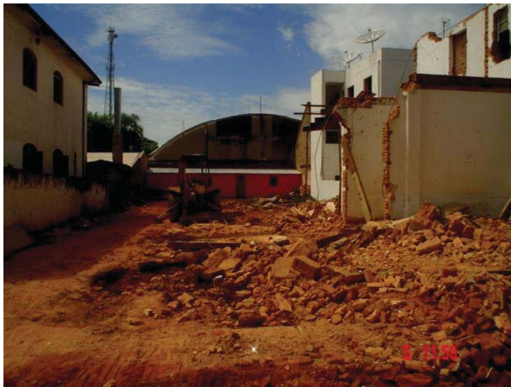
FIGURA 32B - Demolição do antigo Palace Hotel, quarteirão a leste da praça da matriz, onde tem destaque a pedra grés - material que foi usado nas construções do período da missão jesuítica e posteriormente reutilizado pelo homem moderno
