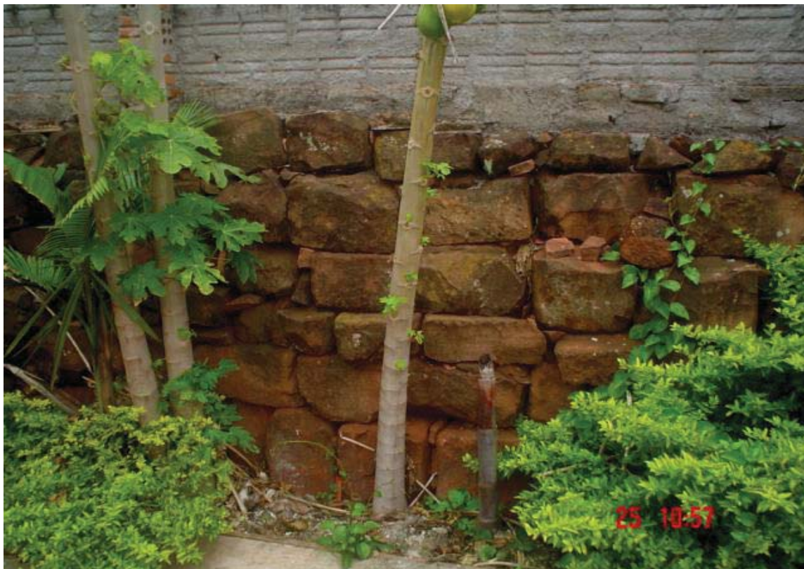
FIGURA 26B - Muro do pátio de residência - quarteirão Oeste da Praça da Matriz Fonte: BRESSAN VIEIRA, (2009). Fotografado por José Alberto Pinheiro Vieira.
